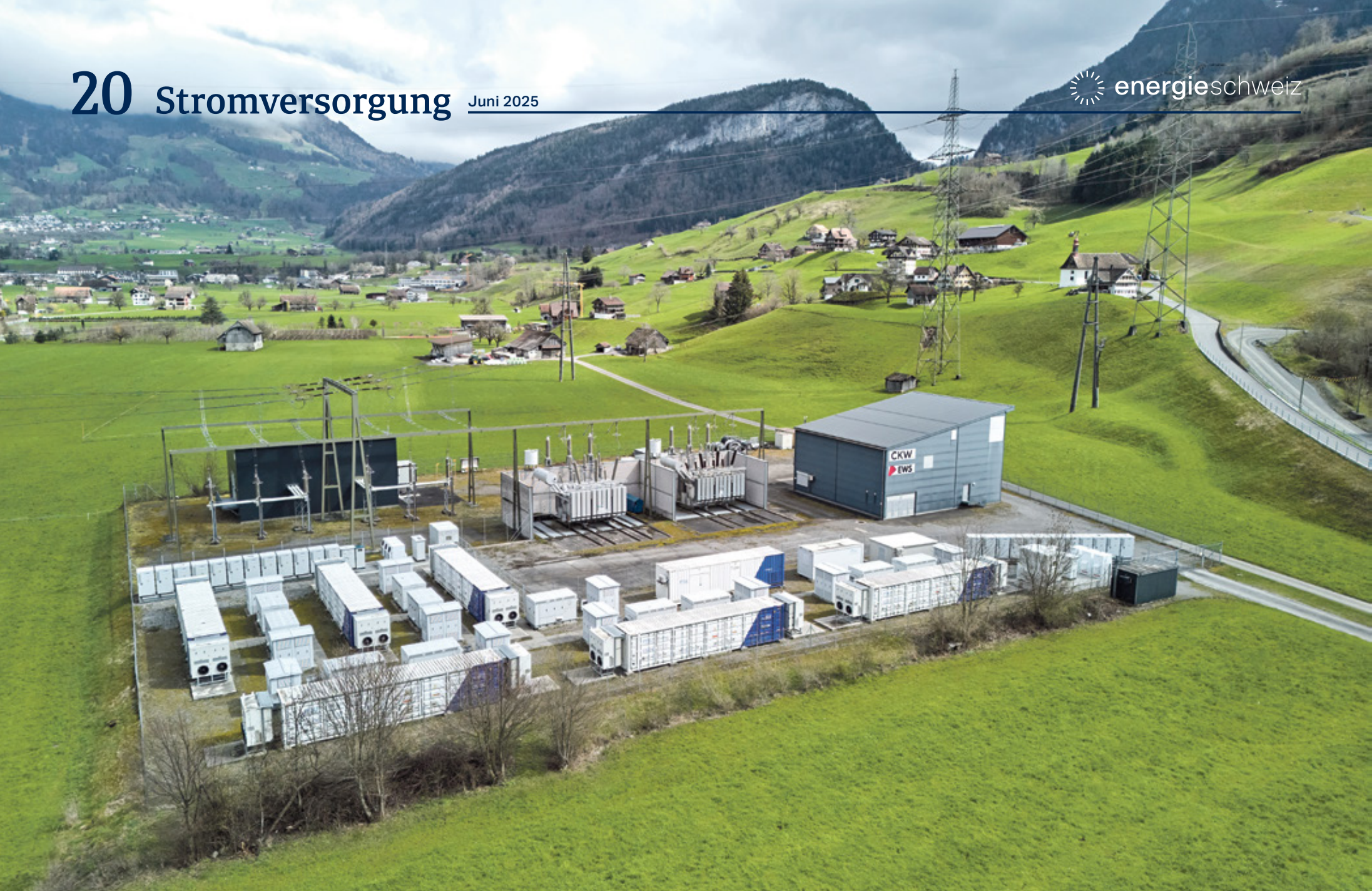
Blick auf die derzeit grösste Speicherbatterie der Schweiz in der Schwyzer Gemeinde Ingenbohl.
